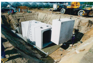
aブロック据付け これでブロック据付けは完了です。
