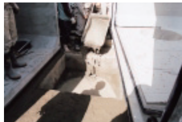
モルタル充填 基礎ピット内にモルタルを充填し、ピット付きブロックを据付けます。
