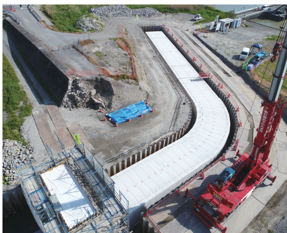
樋管での使用
