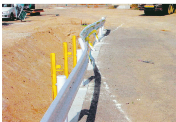
衝突後の状況（直接基礎上）
