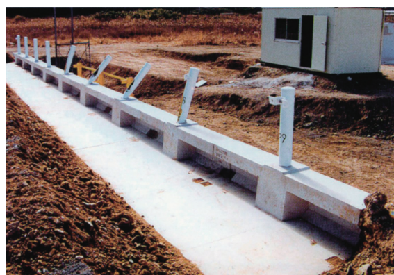
衝突後の状況（補強土壁上）
