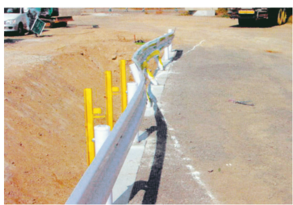
衝突後の状況 (直接基礎上)
